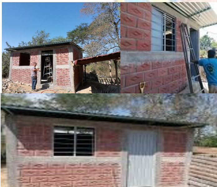
CONSTRUCCION DE CUARTOS DE DORMITORIO EN LA LOCALIDAD DE CRUCERO DE EL ZAPOTE
