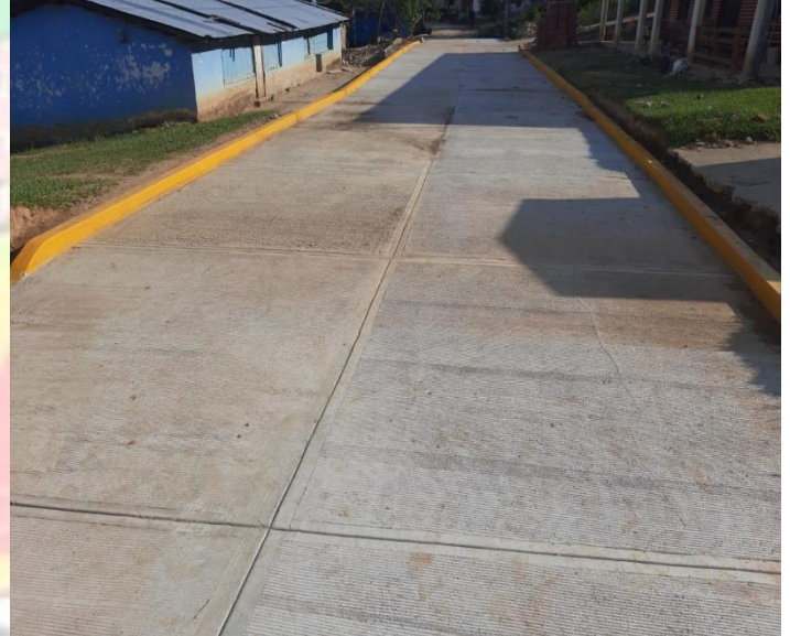
CONSTRUCCION DE PAVIMENTACION CON CONCRETO HIDRAULICO EN LA LOCALIDAD DE CIENEGA DEL SAUCE
